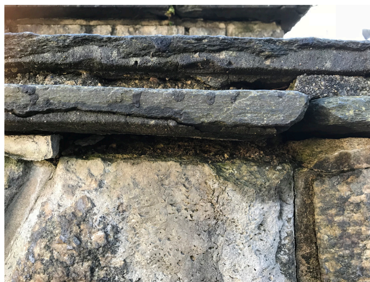
MØRTEL I LUFTETARNENE ER BORTE
